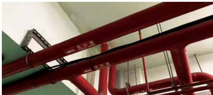
消防安全設備配管
