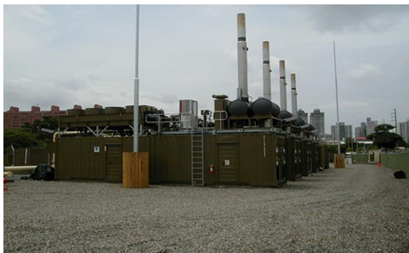
圖 4 西青埔沼氣發電廠 [5]
