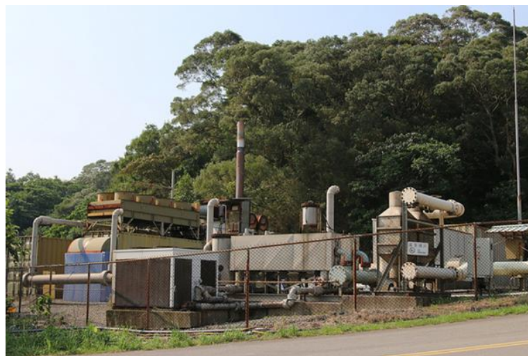
圖 6 台北市環保局福德坑垃圾衛生掩埋場沼氣發電設施 [7]
