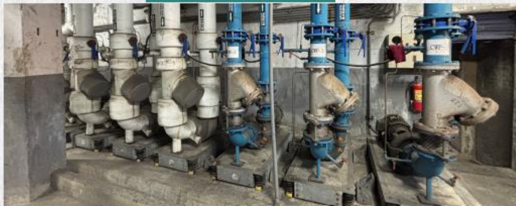
冰水泵& 冷卻水泵
