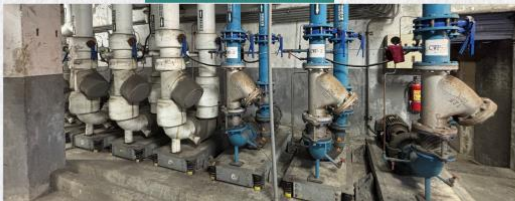
冰水泵& 冷卻水泵
