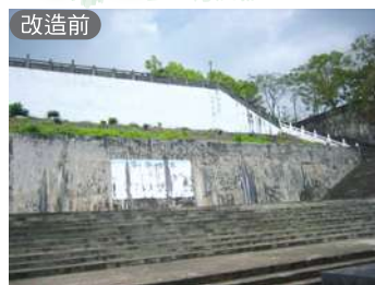
改善前 改善前土木設施景觀突兀。
