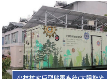
小林村家戶型儲電系統(太陽能光電3KW 儲能設備6~10kWh)
