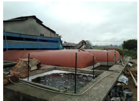
圖3-9 畜牧廢水設施處理情形
