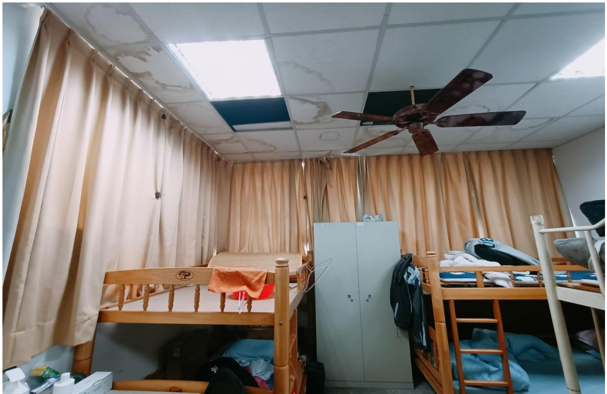
2 (施工前) 橋頭所，3樓露臺漏水至待勤處所天花板(南側)
