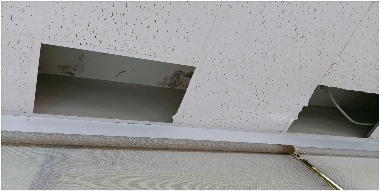
1 (施工前):橋頭所，3樓露臺漏水至待勤處所天花板(北側)
