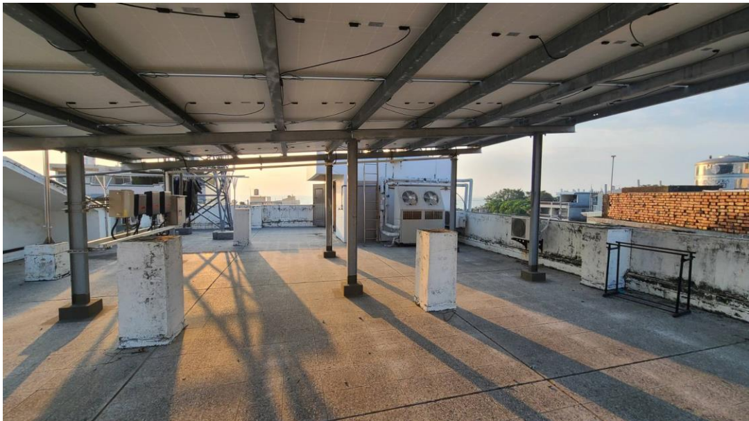
20（施工前）赤崁所待勤室大門上方露臺漏水至2樓照片
