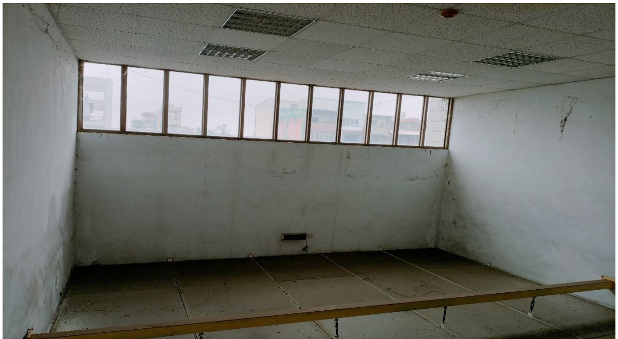
7 (施工前)橋頭所窗框漏水照片
