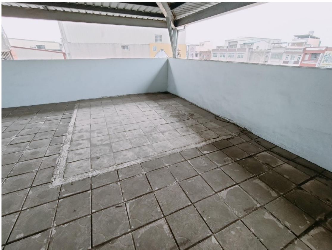
4（施工前）橋頭所3樓露臺漏水，地磚防水層破裂照片
