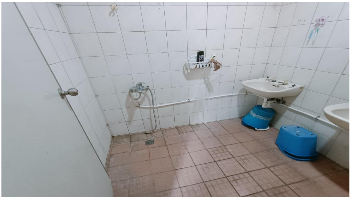
3（施工前）橋頭所女待勤室衛浴設備故障，多處漏水
