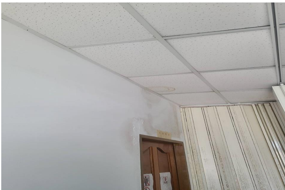
18 (施工前)赤崁所待勤室大門上方漏水照片
