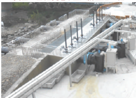
旗山區市區五號排水溝抽水站
