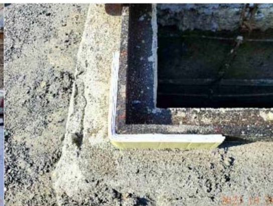
方形孔蓋角隅裂縫改善
