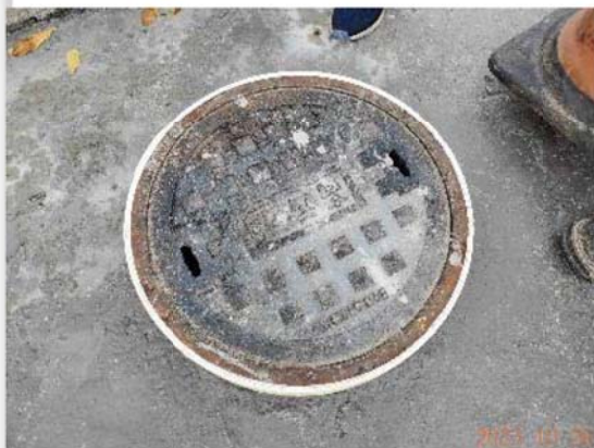
圓形孔蓋裂縫改善
