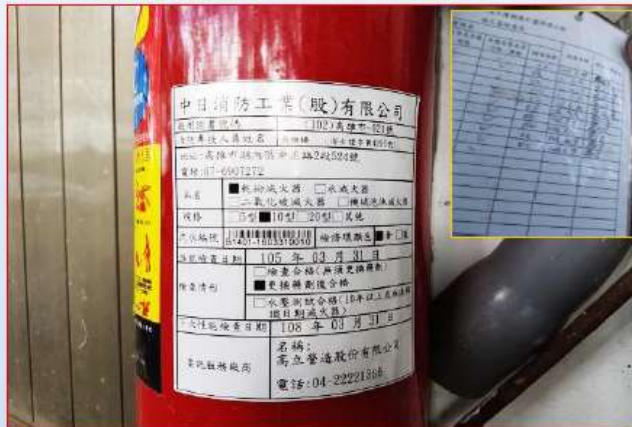
滅火器定期檢查是否於有效期限內
