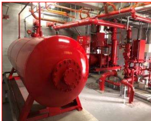
高發泡滅火設備
