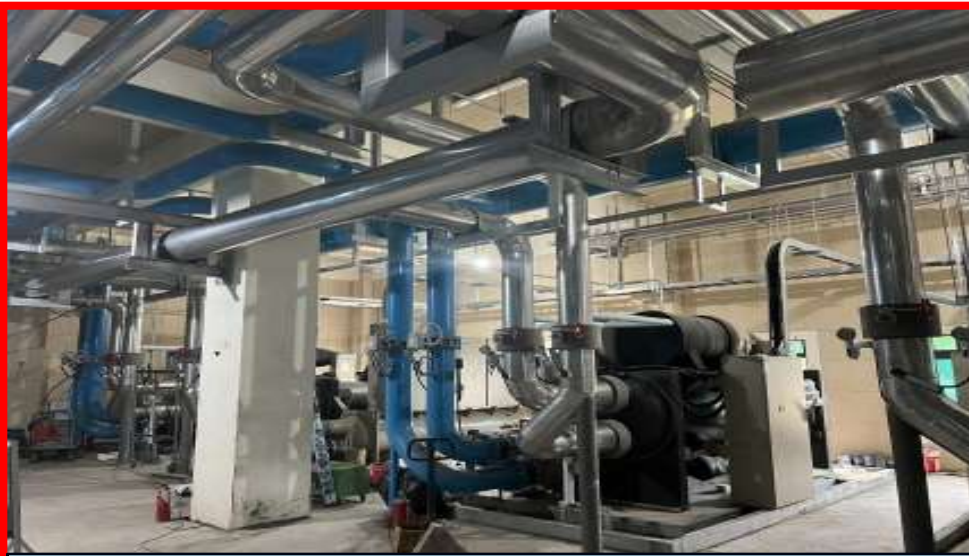
9°C 冰水主機群(CH-4/5/6*2+1台)
