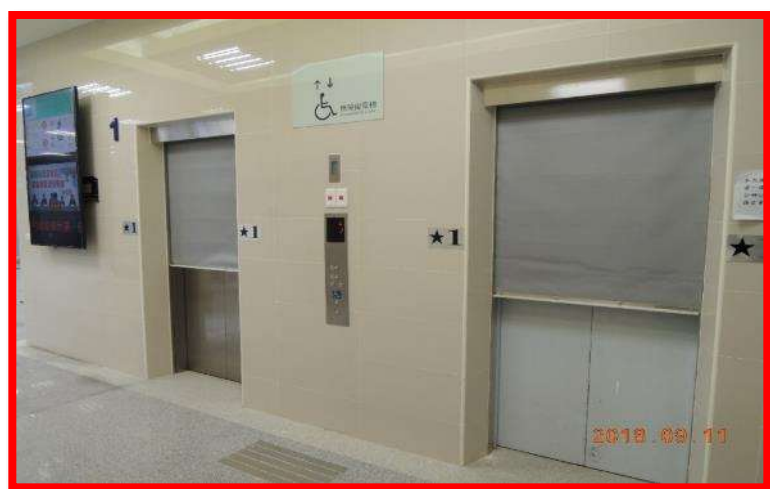
火災時電梯安全連動
