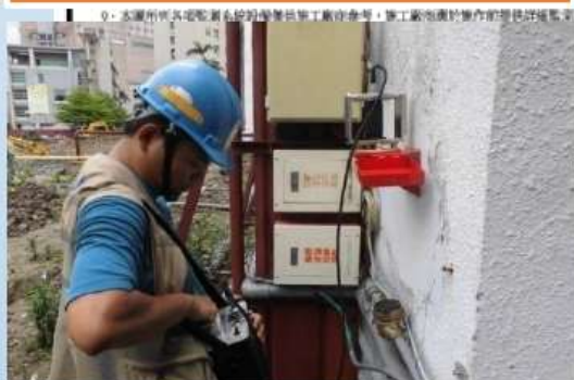
鄰房傾斜計 自動及人工觀測系統
