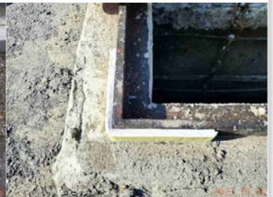
方形孔蓋角隅裂縫改善
