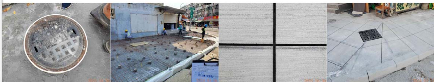
圓形孔蓋裂縫改善
