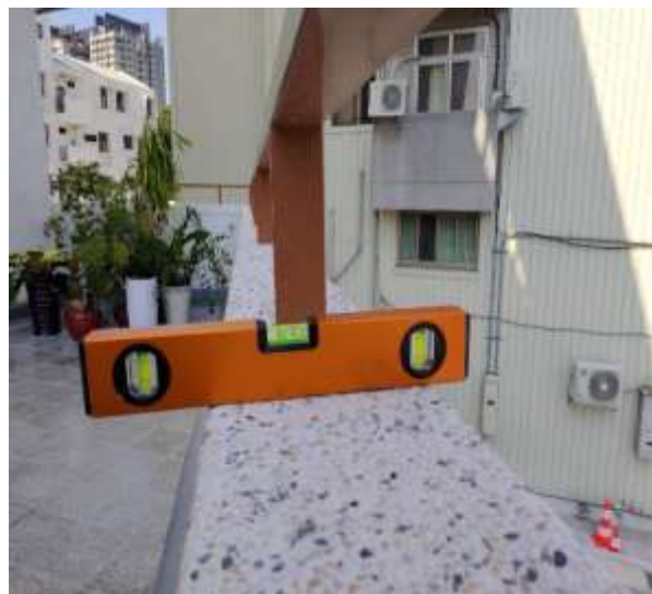
欄杆內斜防外牆汙染
