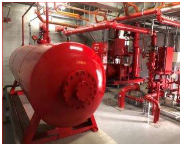
高發泡滅火設備
