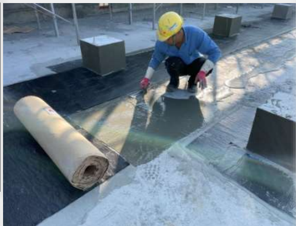
2mm自黏式防水膜 雙層鋪貼(搭接10cm順水方向、東西向及南北向貼附)
