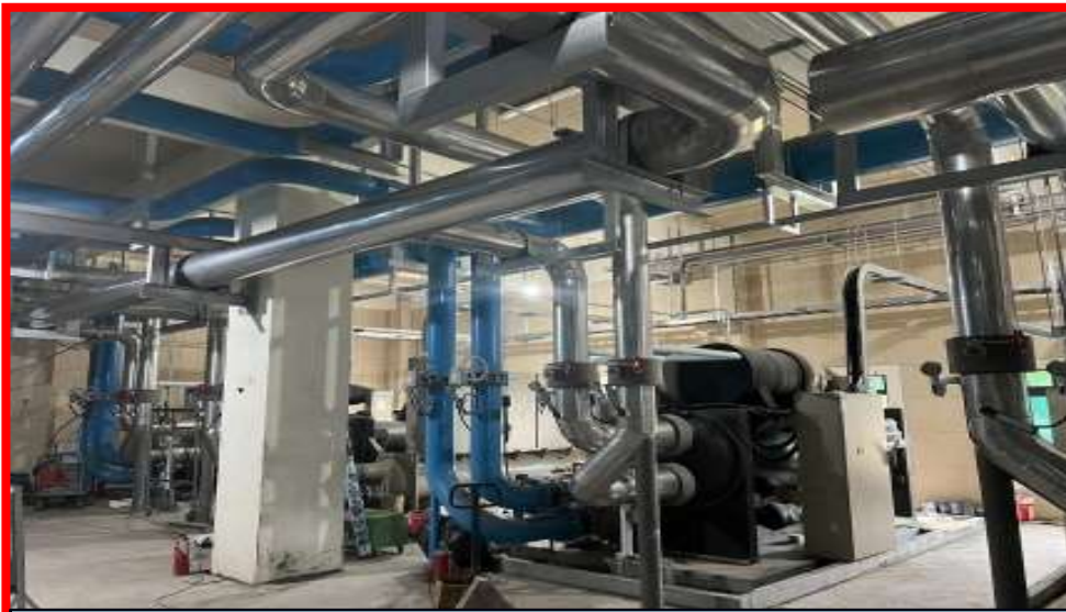
9°C 冰水主機群(CH-4/5/6*2+1台)
