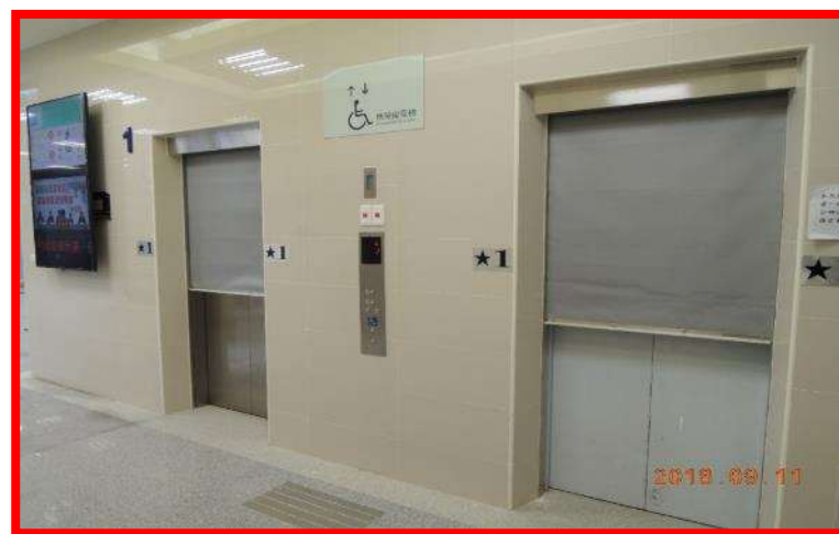
火災時電梯安全連動
