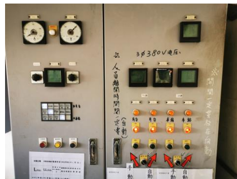
岡燕地下道 抽水機測試正常
