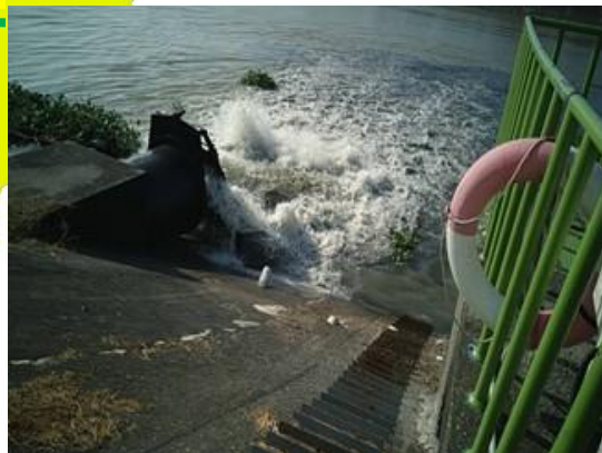
戰車壕溝抽水站 抽水機功能正常
