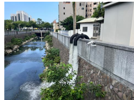
德山街抽水站 抽水機功能正常
