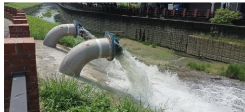
澄觀路1588巷抽水站 抽水機功能正常
