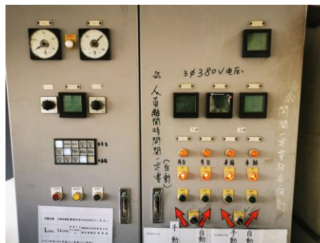
岡燕地下道 抽水機測試正常
