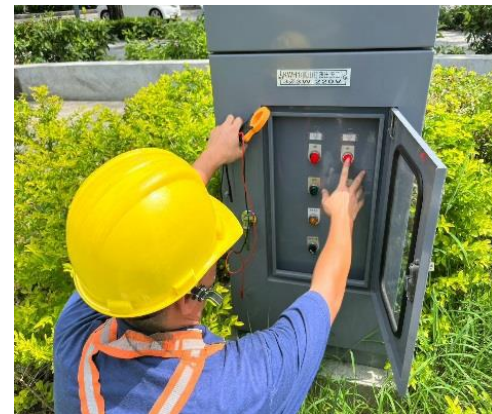
府前滯洪池 抽水機功能正常
