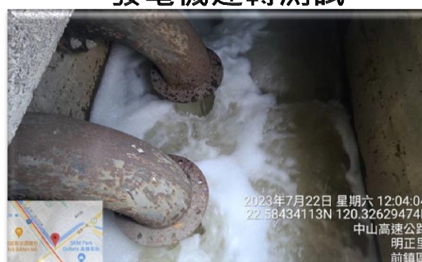
車行地下道抽水機測試
