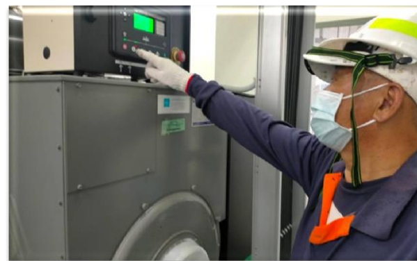
發電機運轉測試
