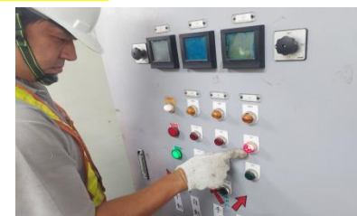
岡山大德三地下道 抽水機測試正常
