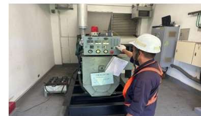
大寮地下道 發電機測試正常
