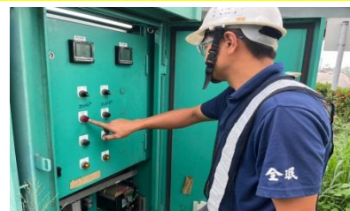
前鎮新生地下道 抽水機測試正常
