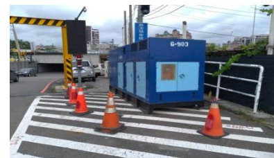
仁武後港巷地下道 備援發電機整備
