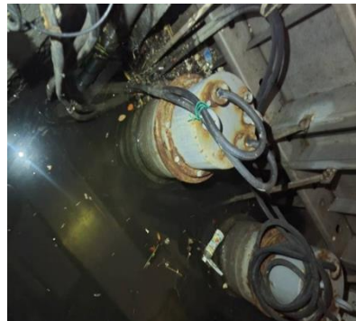
河西路抽水站閘泵無法出水
