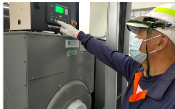
發電機運轉測試
