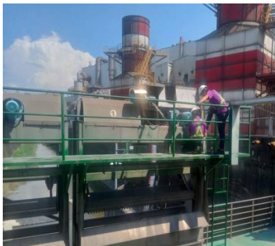
潭底小抽水站撈污機故障短期間無法修復
