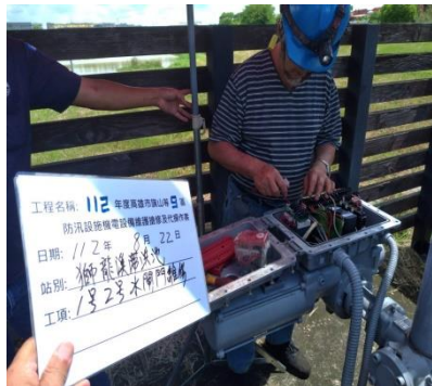
獅龍溪滯洪池閘門受雷擊故障
