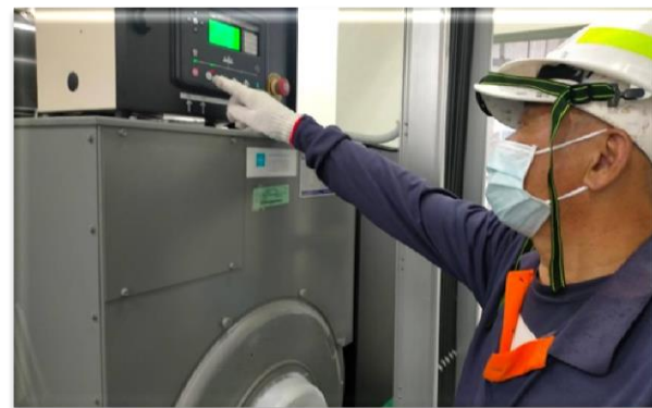
發電機運轉測試
