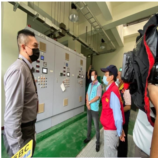
旗山區溪洲抽水站
