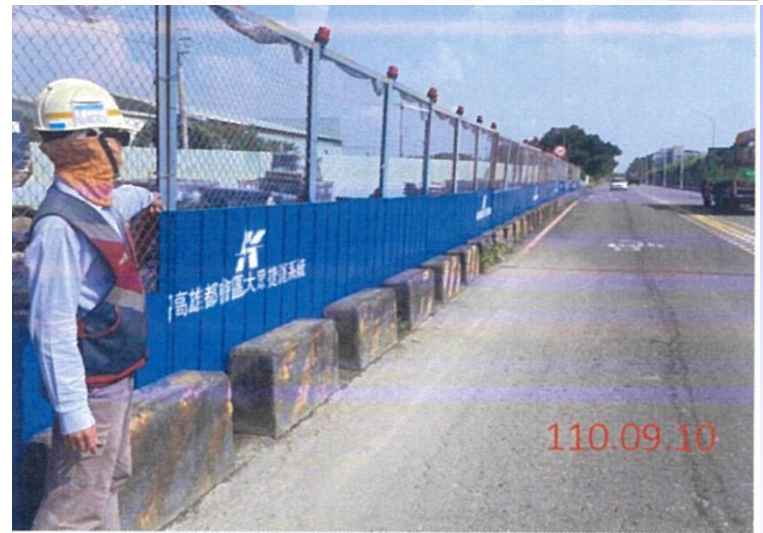
岡山路竹一階工區施工圍籬、紐澤西護欄皆加固、警示燈正常
