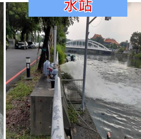
前鎮區鎮州抽水站
