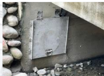
文建街(曹公圳處)雙側側溝設置舌閘防阻倒灌
