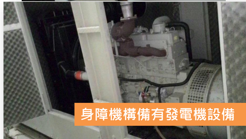
身障機構測試相關防災設備
