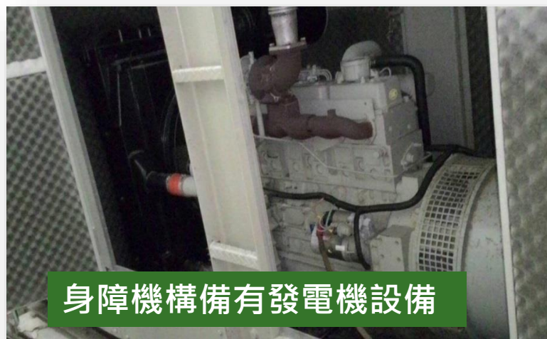
身障機構測試相關防災設備
