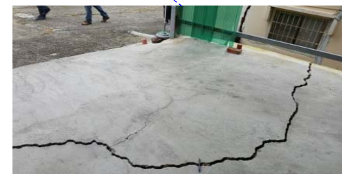
山區聚落庭院地表受損情形
