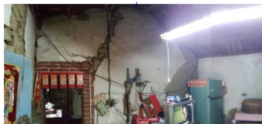
山區聚落房屋受損情形
