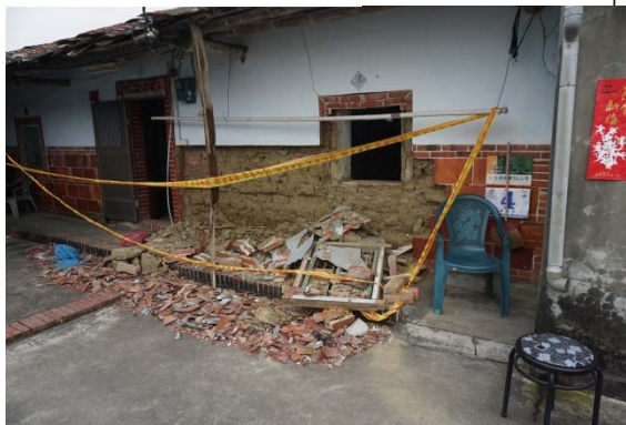
磚造民房損壞
