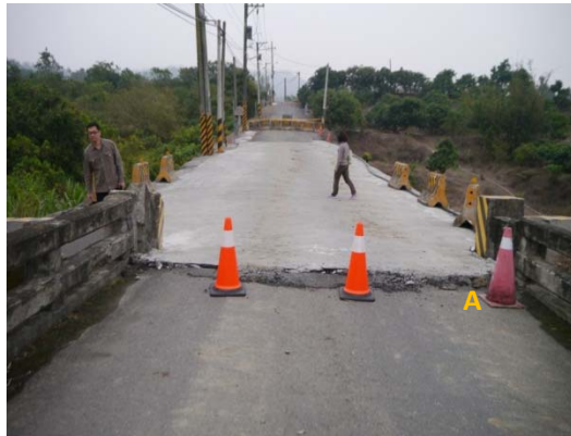
東豐橋：橋面與道路產生落差、龜裂
