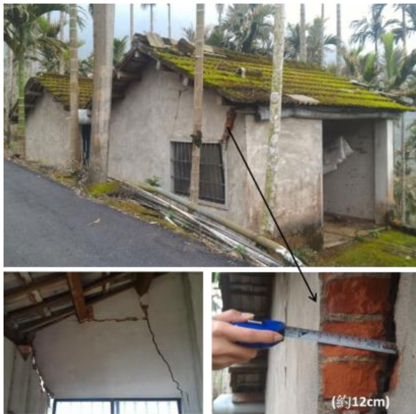
圖 4.2.15、水底寮一處疑似此地震造成破壞之建築 (資料來源：災防科技中心)
