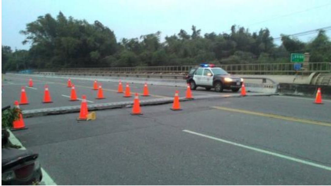
圖 2.7.4、台 3 線 396K+700(內門東勢埔橋) 橋面下陷 10 餘公分 (資料來源：交通部)
