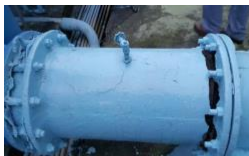
(b)潭頂場內抽水機出水管扯裂
