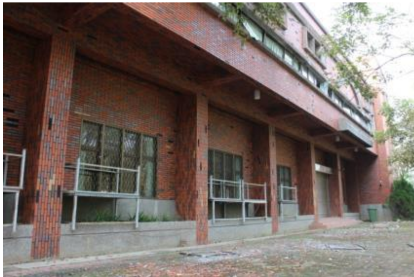
圖 3.2.5、玉井國中活動中心牆面磁磚脫落，部分窗戶掉落（國震中心提供）
