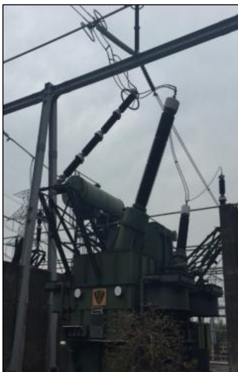
圖 2.3.5、龍崎 E/S 避雷器設備受損情形(台電公司)
