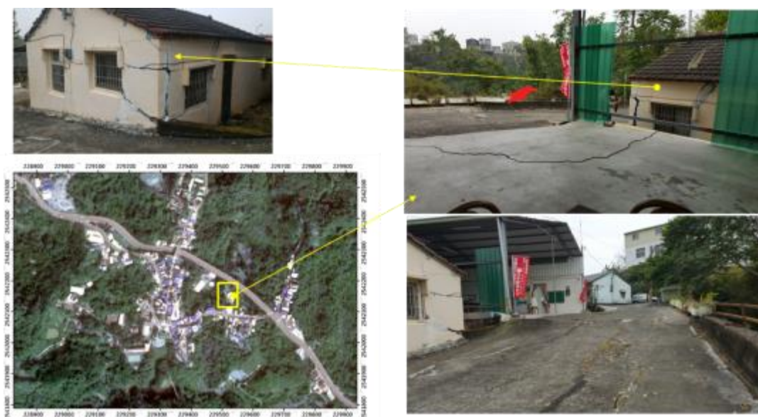
圖 4.2.4、龍崎衛生所後方道路與房屋 (新市子 161 號旁) 龜裂情形 (資料來源：災防科技中心)
