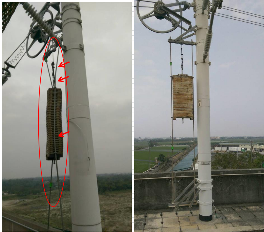
圖 2.7.6、高速鐵路之張力平衡裝置配重塊導桿(左側為受地震損壞,右側為正常。 資料來源：高鐵公司)
