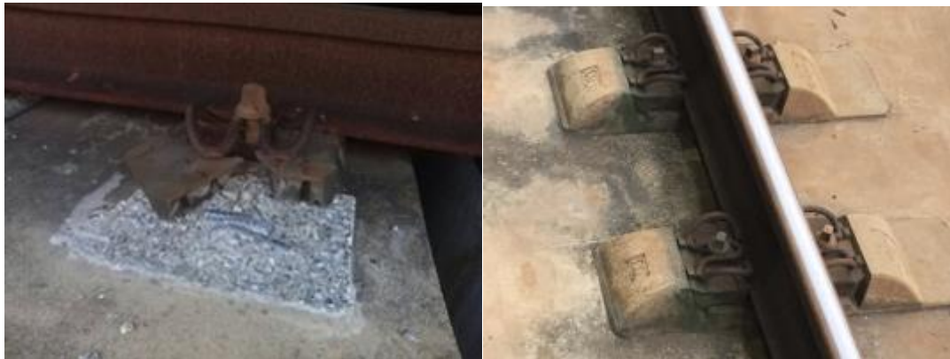
圖 2.7.5、高速鐵路之 RHEDA 道版軌枕(左側為地震造成損壞，右側為正常，資料來源：高鐵公司)
