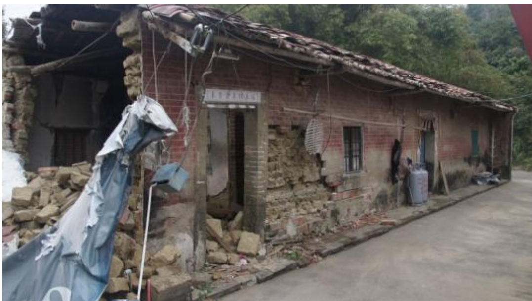
圖 4.2.3、土崎里考潭 14 號房屋損毀 (資料來源：災防科技中心)
