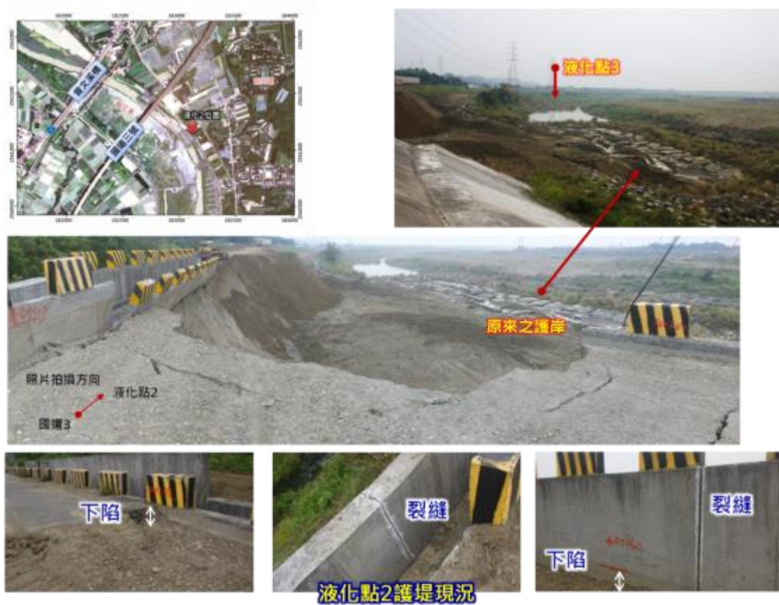
圖 2.1.4 (續)、土壤液化造成河岸護堤受損
