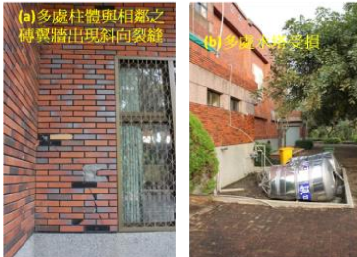
圖 3.2.4、玉井國中活動中心外部受損情形（國震中心提供）
