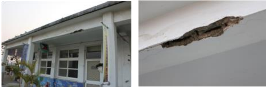
圖 3.2.8、西棟走廊側梁底混凝土剝落，可見梁內鋼筋已生鏽，研判非本次地震造成（國震中心提供）
