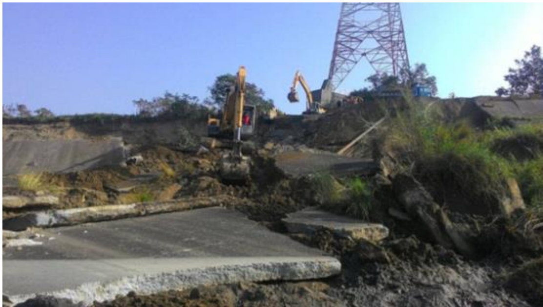
圖 2.8.3、曾文溪日新堤防毀損（資料來源：經濟部）
