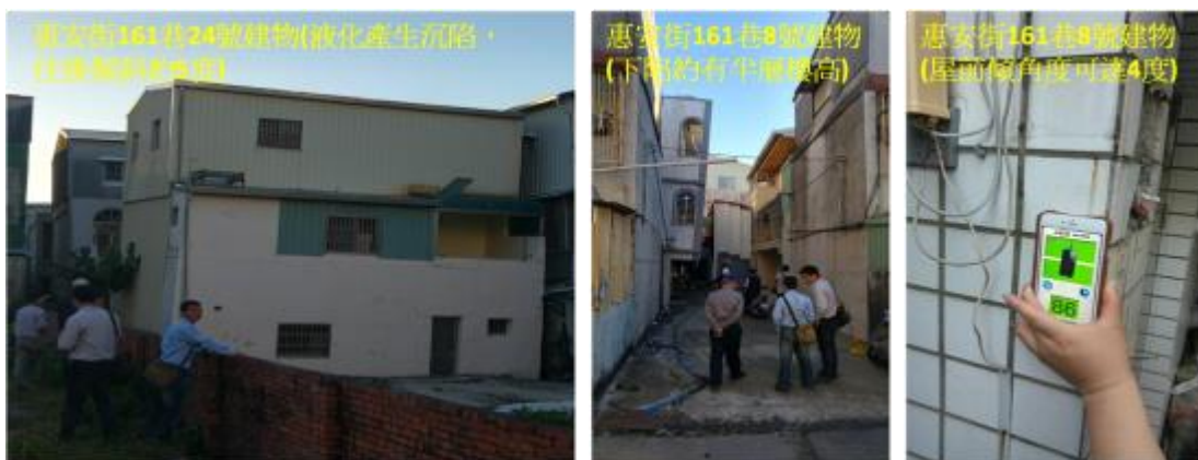
圖 3.2.16、臺南市安南區惠安街 161 巷液化引致建物傾斜下陷 (國震中心提供)
