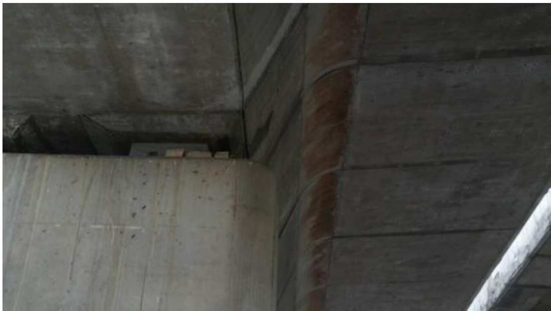
圖 2.7.3、台 86 線 015K+734~016K+239 道路橋面位移（資料來源：交通部）
