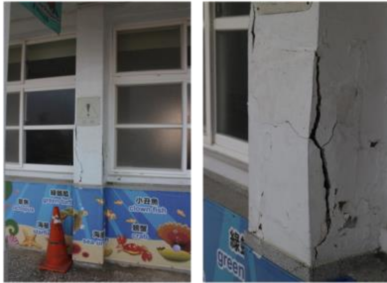
圖 3.2.7、西棟柱體的垂直裂縫，疑似內部鋼筋鏽蝕膨脹（國震中心提供）
