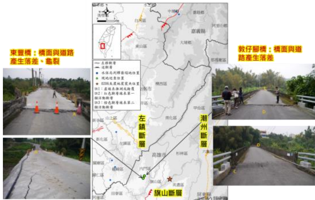
圖 4.2.9、高雄市內門區東豐橋與敦仔腳橋橋面位移與龜裂（資料來源：災防科技中心）
