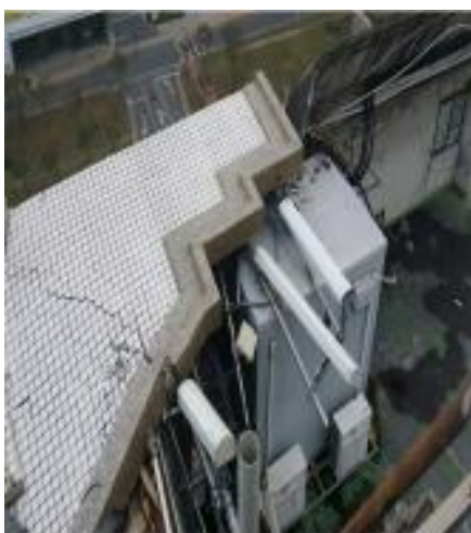
(c)大樓倒塌壓損設備 (台灣大哥大)
