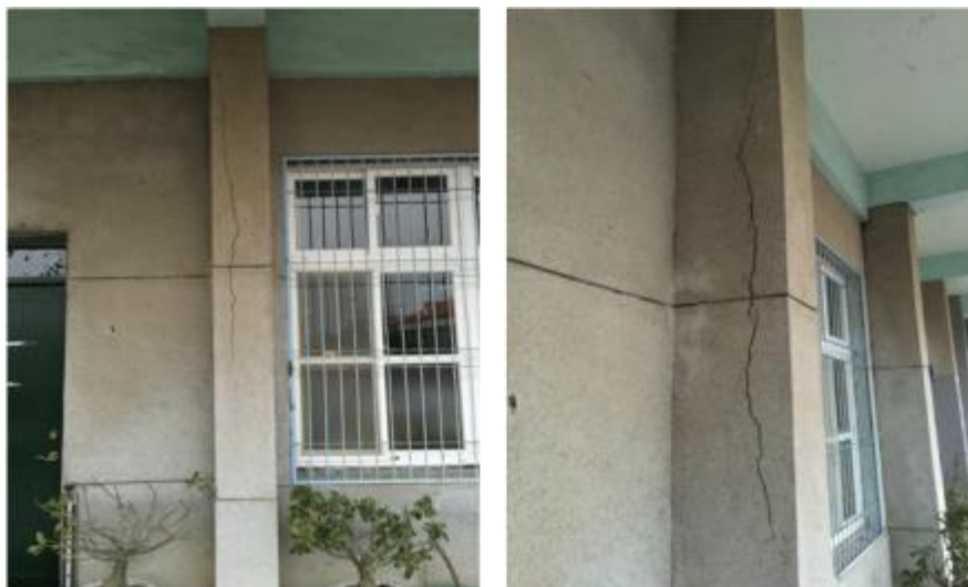
圖 3.2.6、北門國小玉湖分校西棟柱體出現垂直裂縫（國震中心提供）
