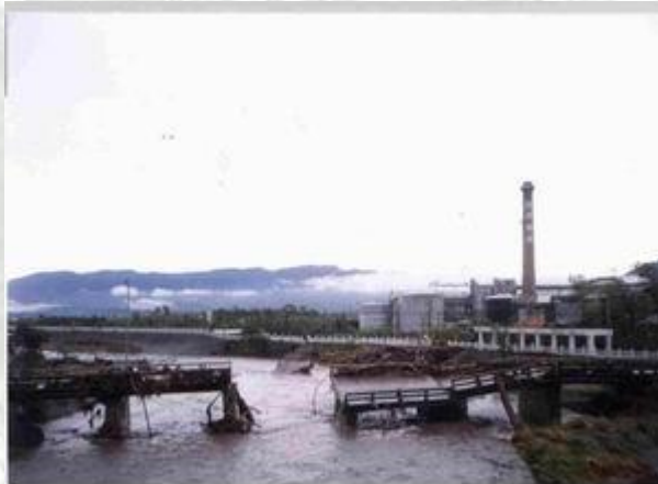
桃芝颱風-橋受土石衝擊破壞
