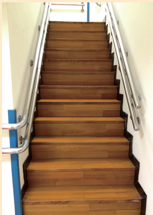
▲ 樓梯無防滑設施、出入口無防護裝置
