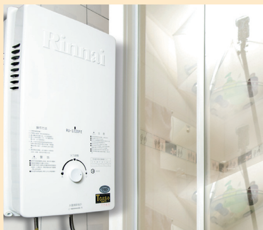
▲熱水器安裝在室內
