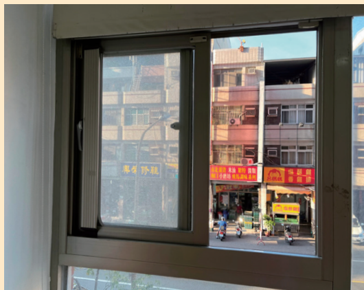
▲窗戶未使用防護裝置
