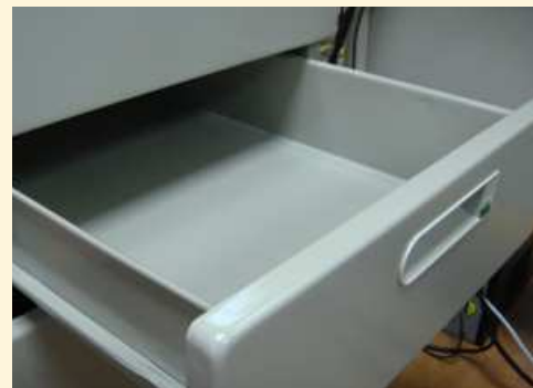
▲抽屜未使用防護設備
