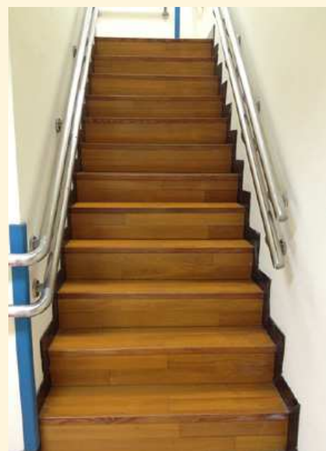
▲樓梯出入口無防護裝置
