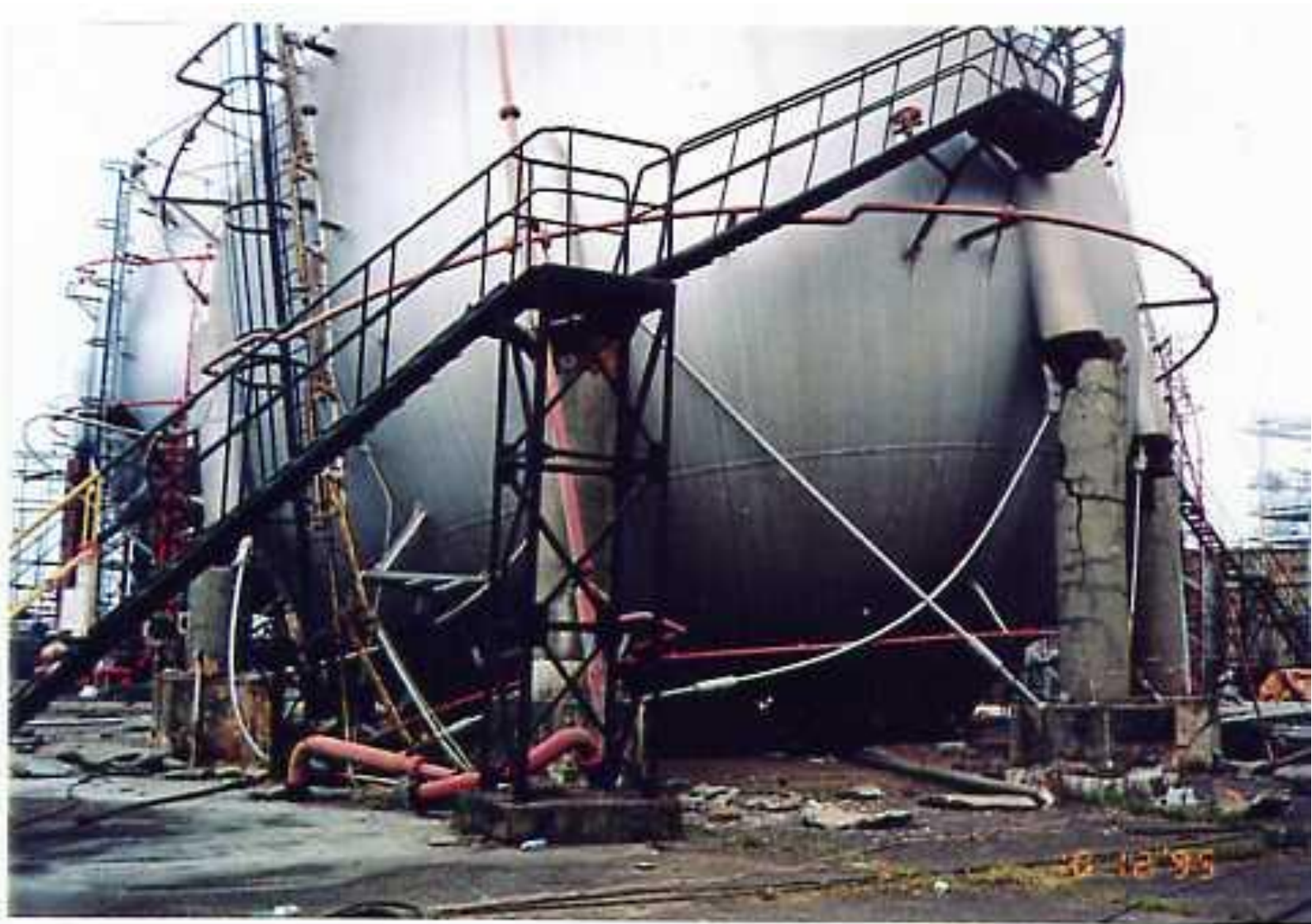
球型槽水壓試驗造成倒塌
