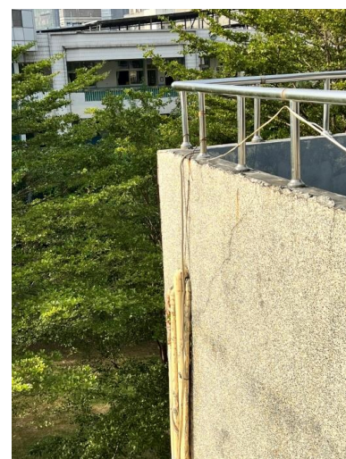
外牆水管壁間生長之樹苗
