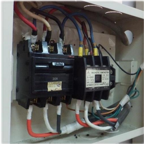
開關箱未設中隔板
