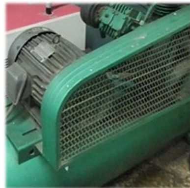
空壓機傳動裝置
