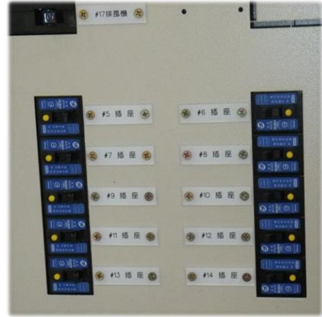
分路設置漏電斷路器
