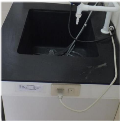
未設漏電斷路器
