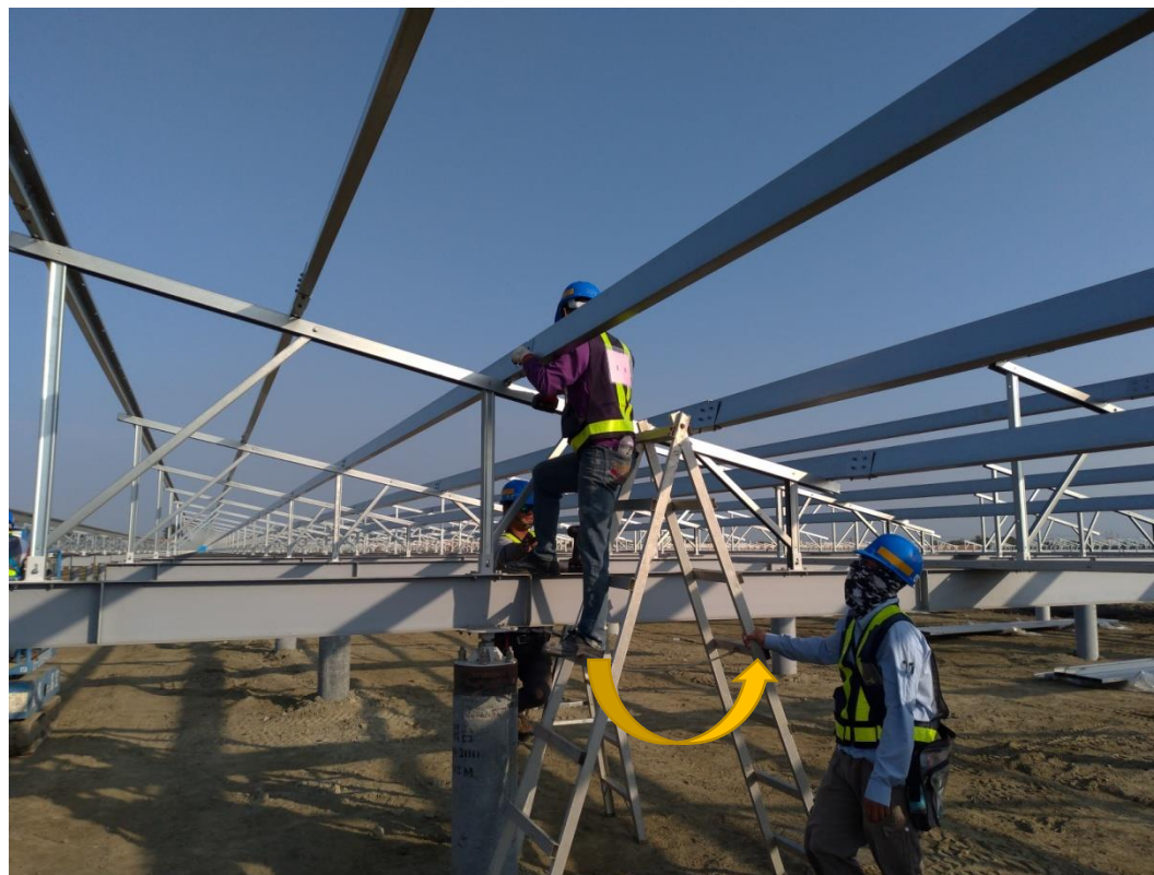
單側踩踏於合梯 中間固定桿非穩固鐵件
