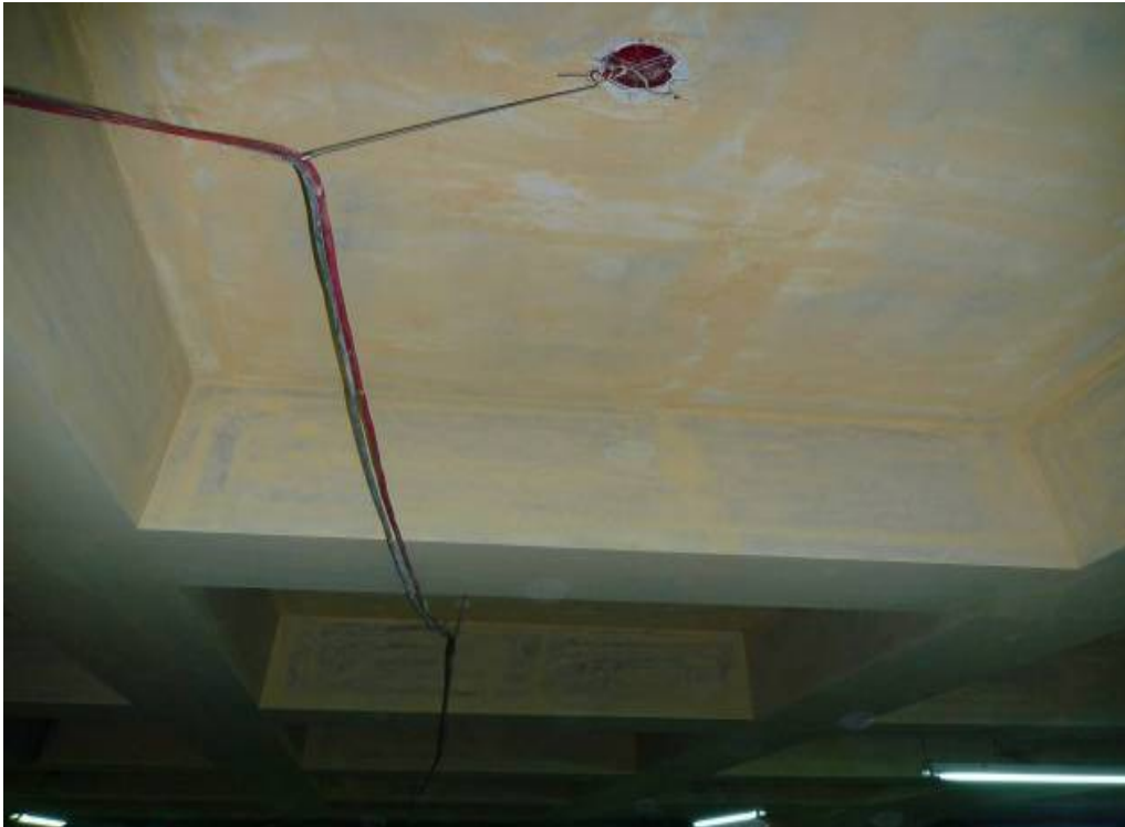
電線架高防護。
