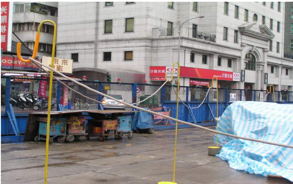
電線架高避免因地面積水導致電線浸水，受外力破壞絕緣而漏電。
