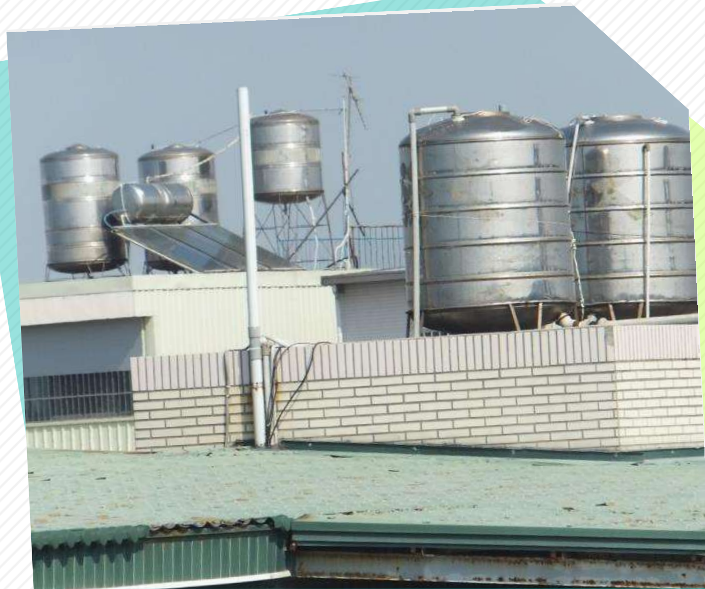
水塔設置及動線規劃不當
