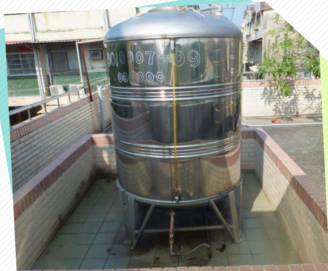
鍋爐柴油未依規定標示
