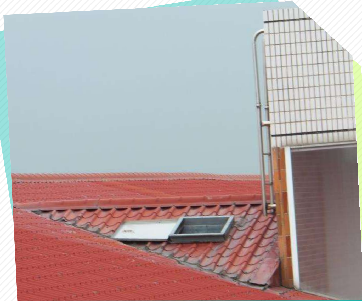
水塔設置及動線規劃不當
