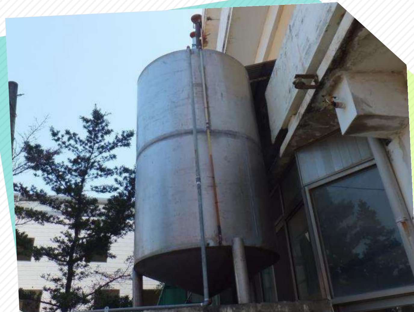
鍋爐油槽設置不當 未設置安全上下設備
