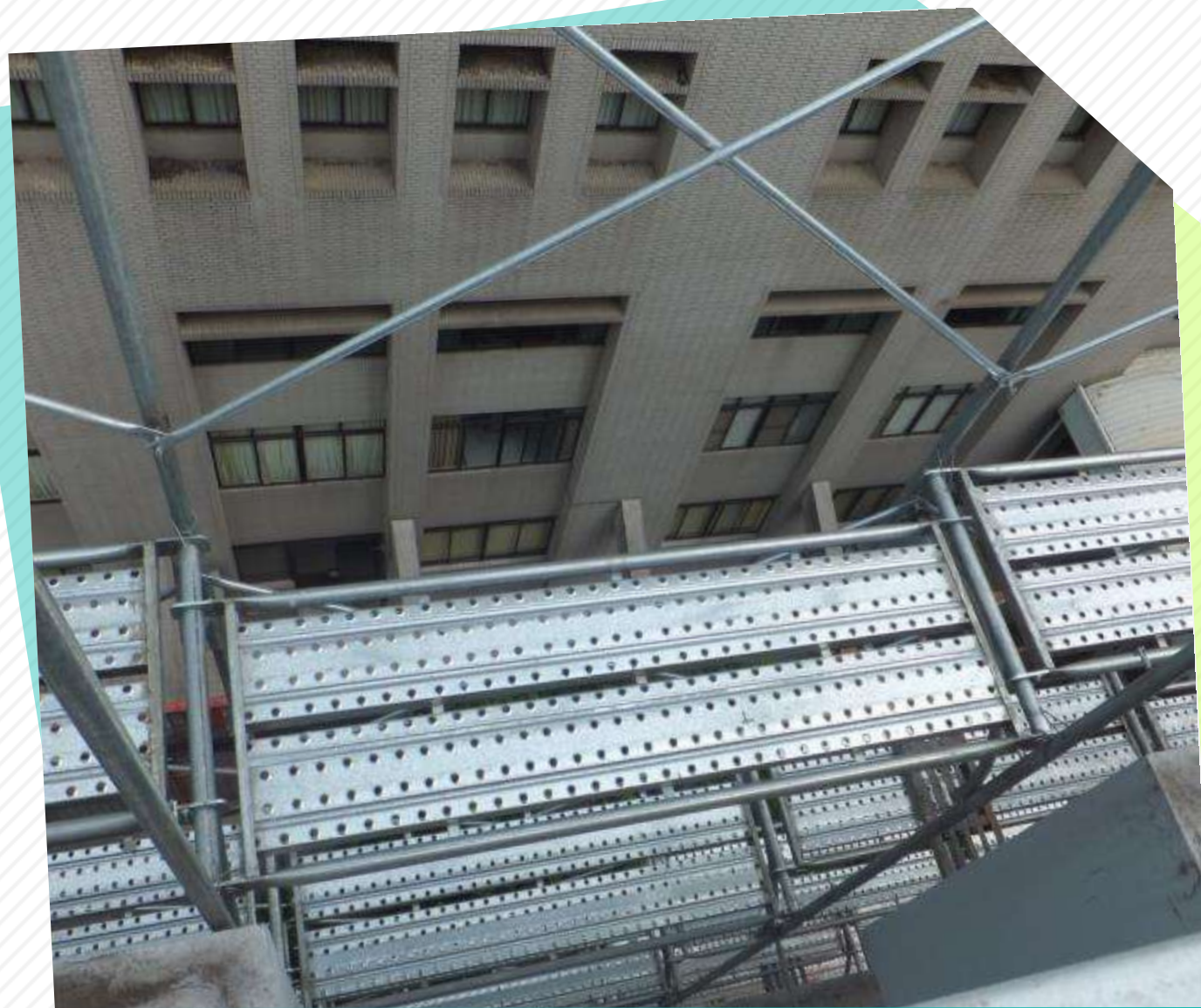
未設交叉拉桿、下拉桿
