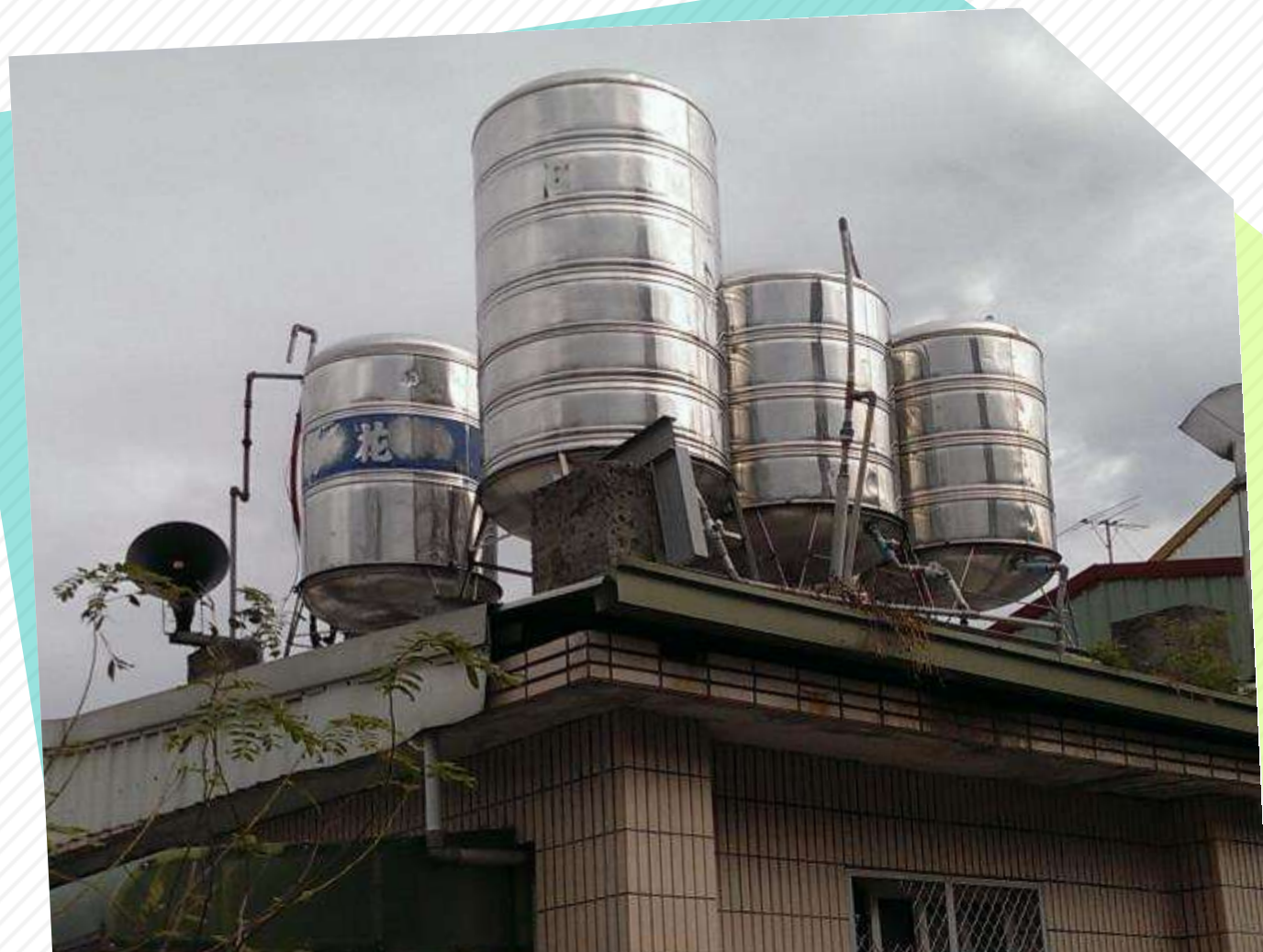
水塔、鍋爐油槽設置不當 未設置安全上下設備
