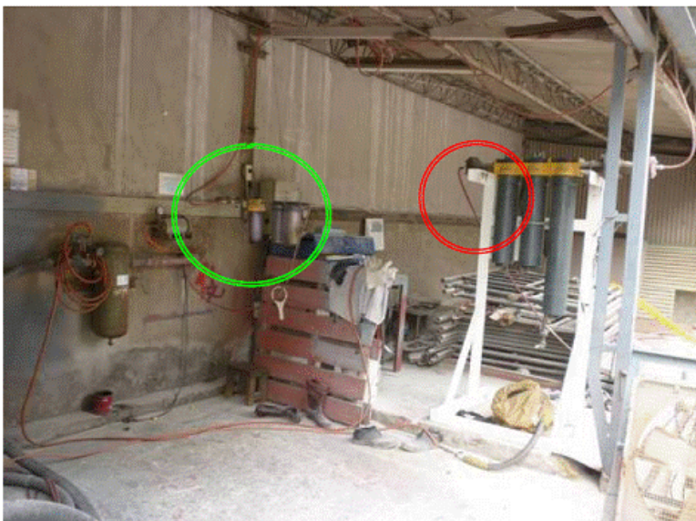
照片 2、事故噴砂作業場所外部之輸氣管相關配管係以空氣供氣(右方及左方圈處)；不明原因被接上氧氣(左圈處之管線)
