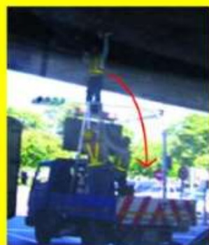
不得將合梯放置於車輛等不穩定處，易造成人員墜落危害。
