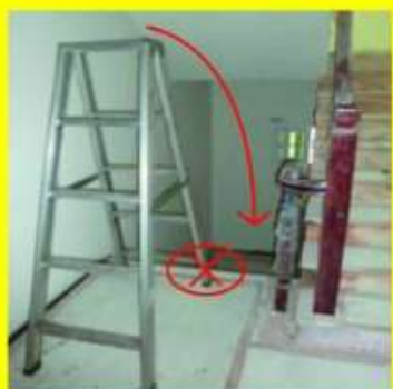
於鄰近樓梯處之合梯上從事油漆作業，墜落致下層樓梯角平台致死。
