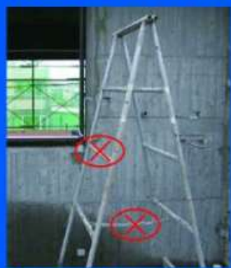
站立第二層(高度約80公分)位置僅為橫桿，未具有安全之梯面，跌落時身體衝撞堆疊在旁之梯板材料致死(完全梯未有硬質繫材)。
