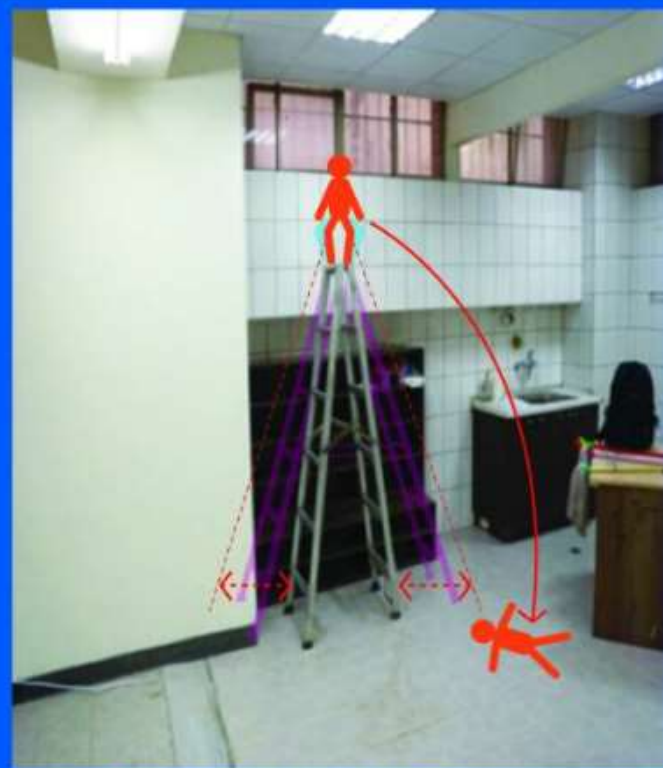
工作中踩著合梯行走造成墜落撞擊頭部傷重死亡。
