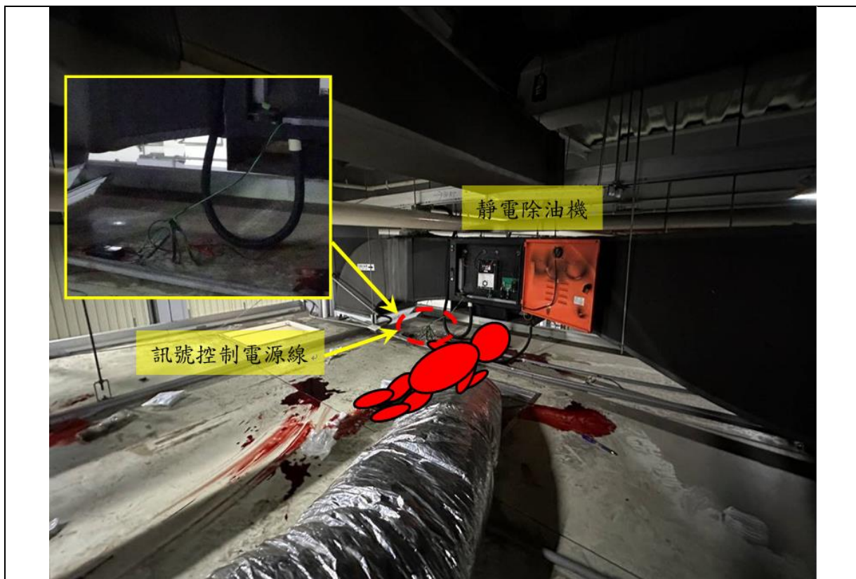
說明 災害現場照片。
