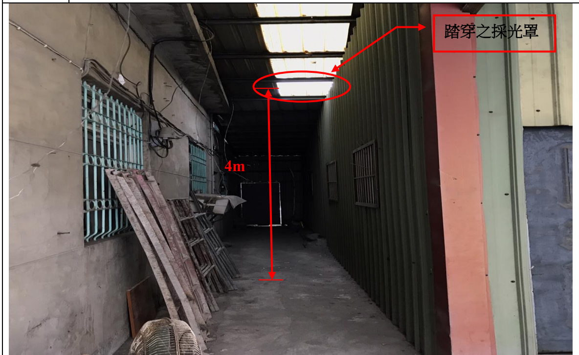
說明二 罹災者踏穿 1 樓屋頂之採光罩墜落於民宅旁之巷子，距離地面約 4 公尺。
