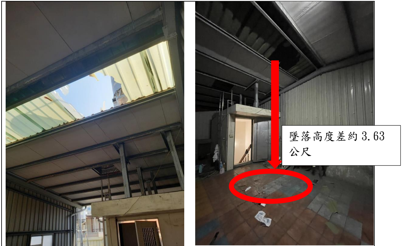
說明 災害發生現場。
