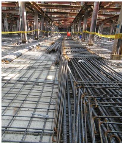
西側未設置 #5 斜撐筋
