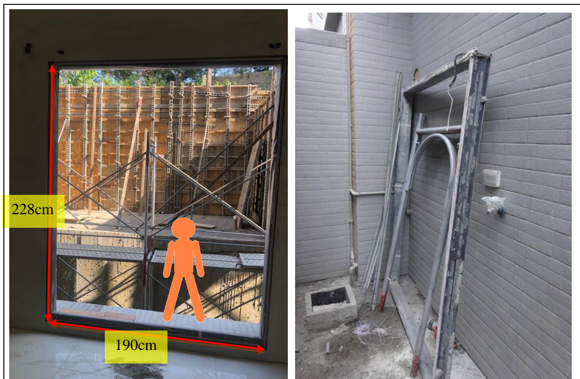
說明 災害發生現場。
