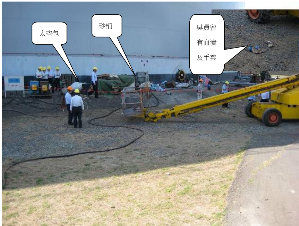
照片 1 太空包吊帶撕裂導致罹災者墜落高空工作車旁
