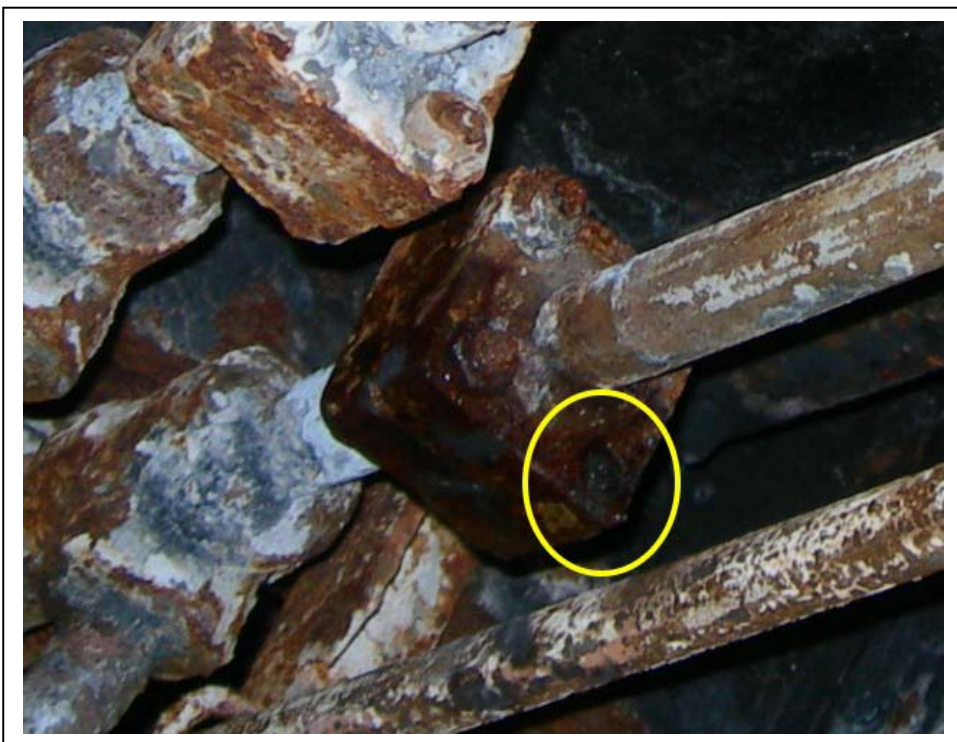
船內臥艙之通道上方油壓系統管線螺接頭栓之螺帽被切斷。
