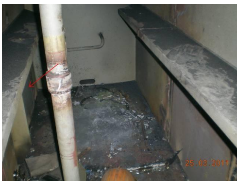
箭頭所指處為事故現場實施電焊作業之處所。
