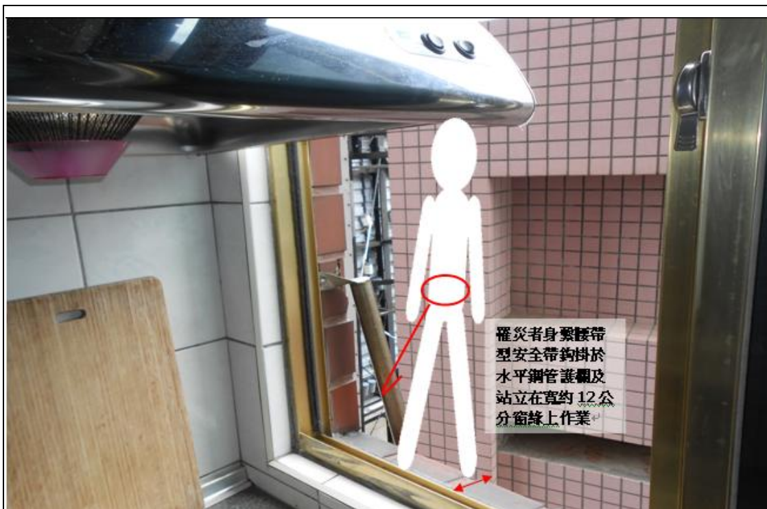
乙站在廚房窗台上作業，安全帶鉤掛於窗外水平鋼管護欄。
