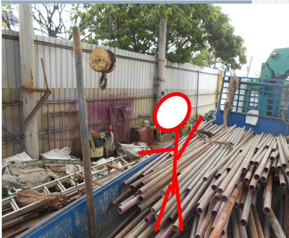
罹災者遭吊掛施工架飛落擊砸位置示意。
