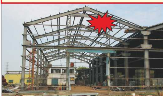
從事廠房整修作業， 自鋼樑墜落 致死災害
