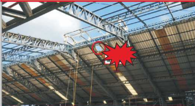
進行屋頂翻修工程，因 踏穿採光浪板 墜落致死災害
