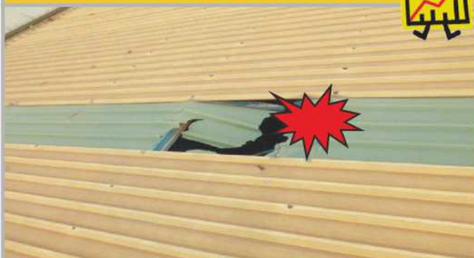
從事廠房屋頂檢修作業，因 踏穿採光浪板 墜落致死災害
