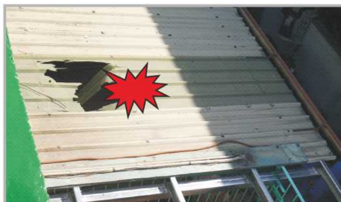
從事民宅整修工作，於遮雨棚因 踏穿採光浪板 墜落致死災害
