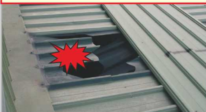
從事廠房浪板更換作業，因 踏穿採光浪板 墜落致死災害
