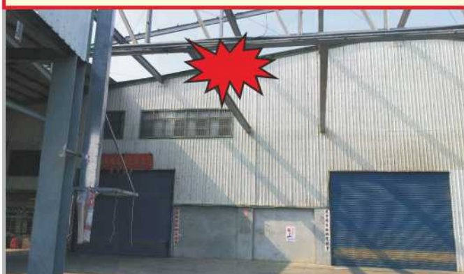
從事廠房浪板拆除作業， 自屋頂邊緣墜落 致死災害
