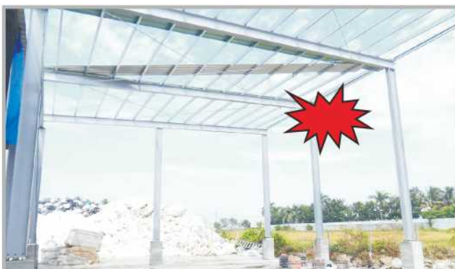
從事遮雨棚新建作業， 自鋼樑墜落 地面致死災害
