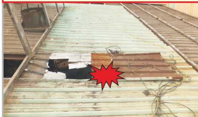
從事屋頂浪板拆除作業，因 踏穿採光浪板 墜落致死災害
