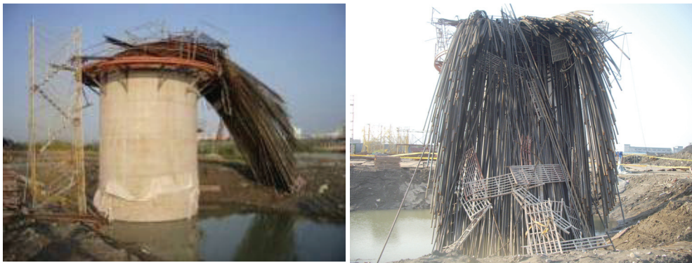
圖 4 發生倒塌之墩柱鋼筋
