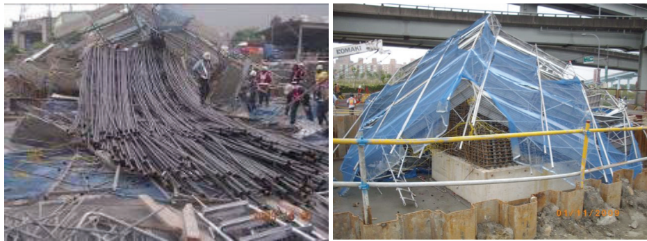
圖 5 墩柱鋼筋續接作業平台發生倒塌
