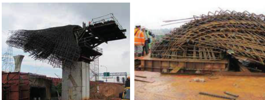
圖 3 發生倒塌之墩柱鋼筋
