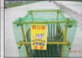
橋面板開口防護
