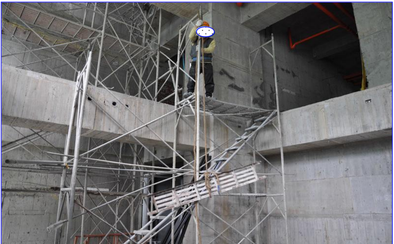
照片 13：施工架拆除作業，使用繩索並以立架為支點，以人力吊運整捆構材（例如立架、交叉拉桿及下拉桿等），因作業勞工無防墜設施，且立架及腳柱接頭無法承受吊掛重量，易造成腳柱接頭彎折斷裂、人員墜落及吊掛物飛落等災害，該搬運方法如未經專任工程人員確認安全性者，應予避免。
