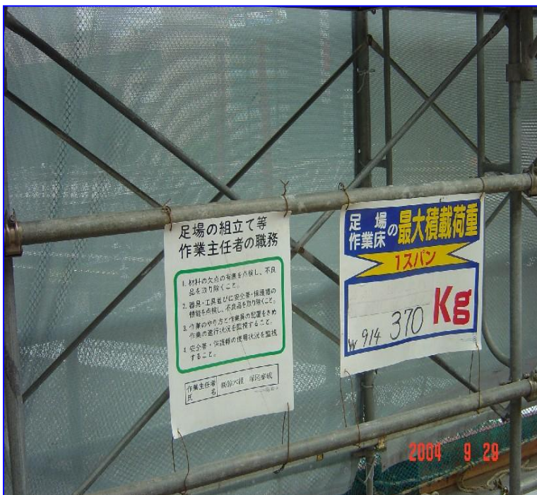
照片 9：施工架上之載重限制，應於明顯易見之處明確標示（以標示單一踏板載重限制為原則；另如經設計須標示整組施工架載重限制，則依須求增加標示該內容）。
