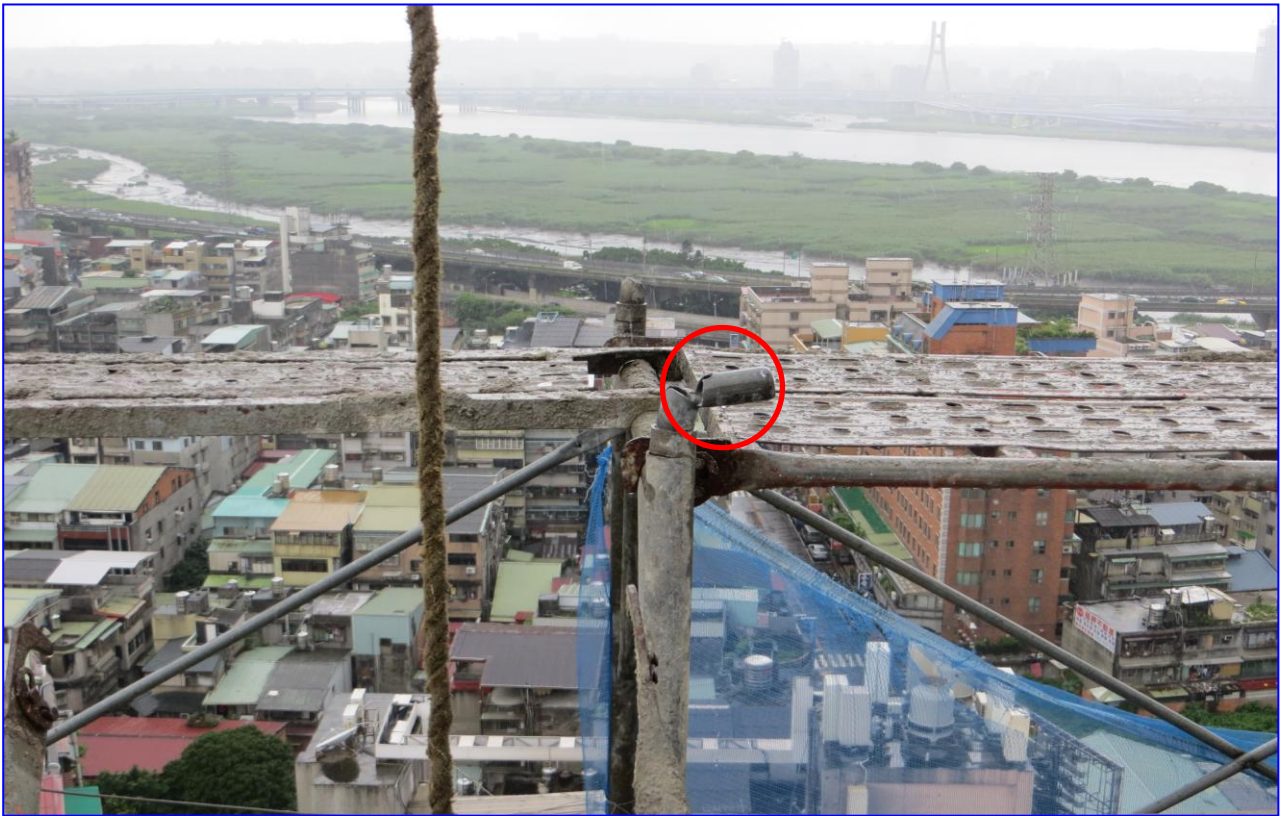
照片 14：未以機械吊運，使用繩索並以立架為支點，以人力吊運整捆交叉拉桿及下拉桿，人員隨倒塌之立架墜落（腳柱接頭斷裂）。
