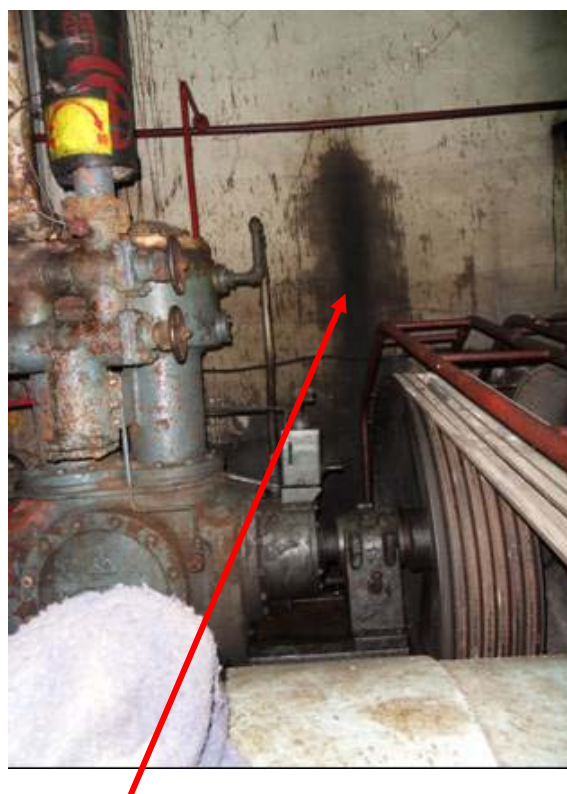
照片二 4 號冷凍壓縮機機頭油封鬆弛，冷凍油噴濺
