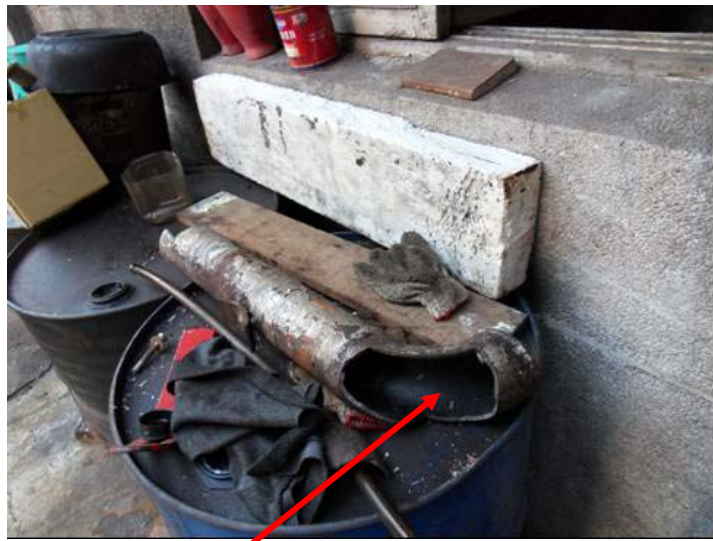
照片四 高壓管破裂狀況
