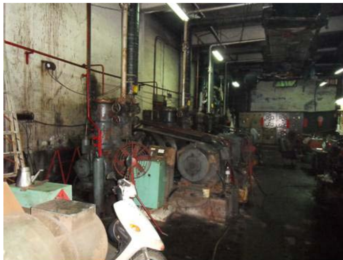
照片一 災害現場位於○○股份有限公司冷凍機房
