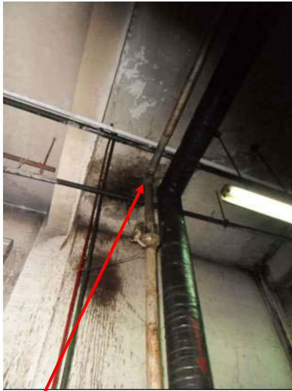
照片三 高壓管破裂位置
