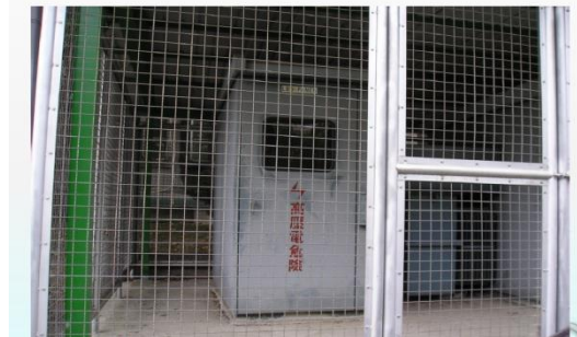
電氣室要有隔離措施
