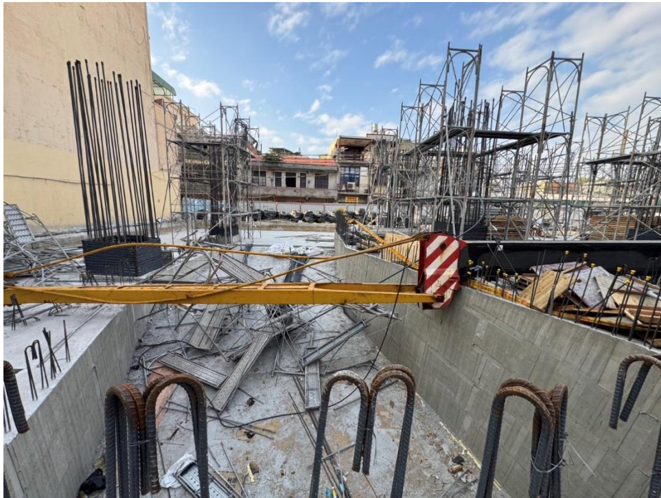
圖二、事故災害現場概況
