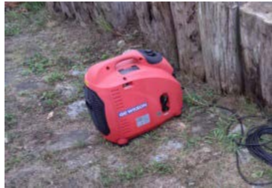
活動現場發電機租賃 (用電含運送及配電工程)
