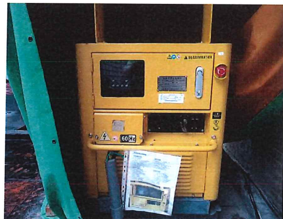
防音型發電機本體或附近貼有操作說明書
